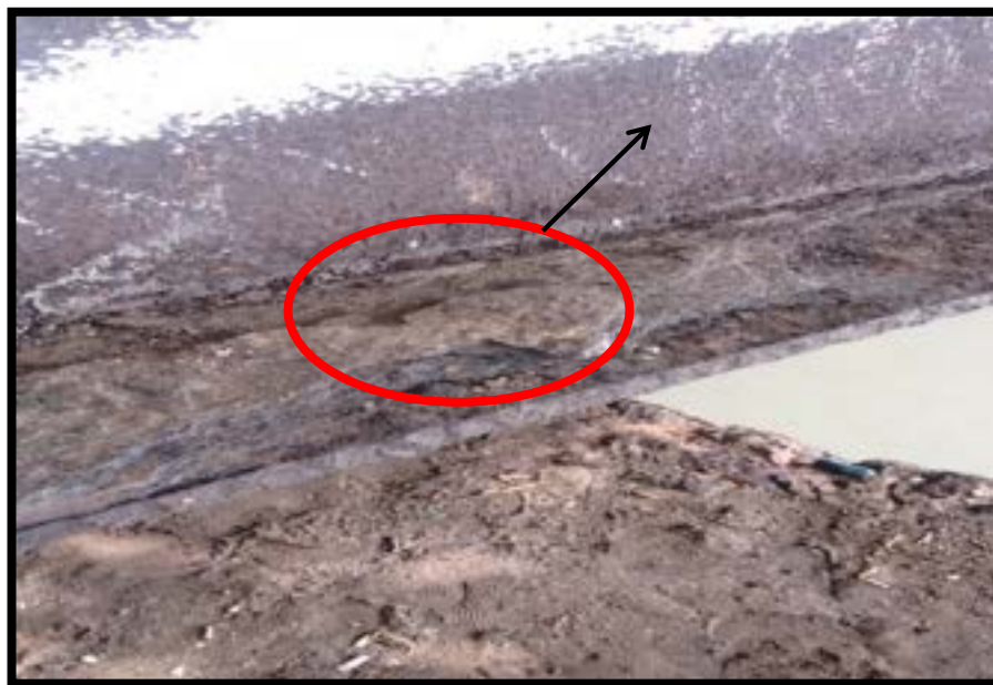
Figura 1. Crosta na estrutura metálica da ponte em constante contato com a água.
