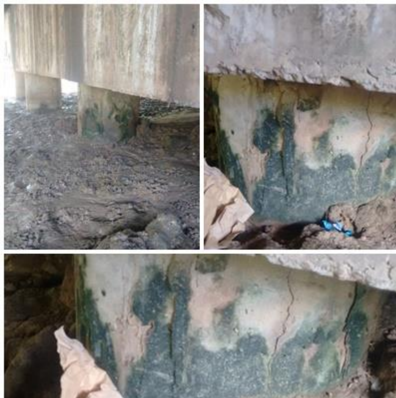
Figura 2. Trincas se propagando em alguns pilares.
