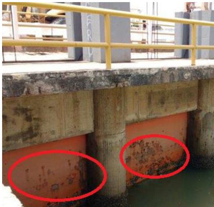
Figura 2. (Propagação da corrosão nas comportas metálicas da barragem do Bacanga).
