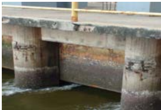
Figura 2. Corrosão na estrutura de concreto da barragem do rio Bacanga. (foto: autor)
