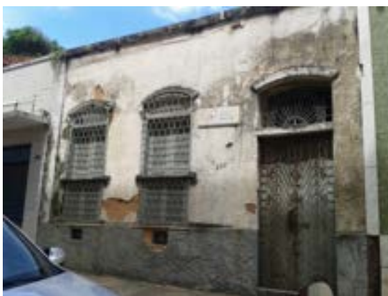
Figura 1. Fotografia de imóvel privado em péssimo estado de conservação, realizada durante a pesquisa de campo. Fonte: Banco de dados do NEUCI.
