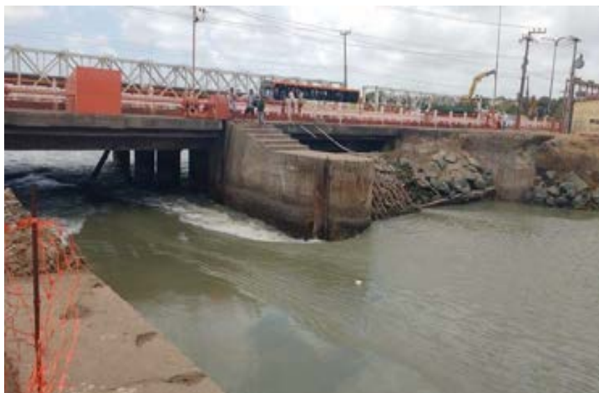
Figura 1. Barragem do rio Bacanga sem uma de suas comportas. (Foto: Autor)
